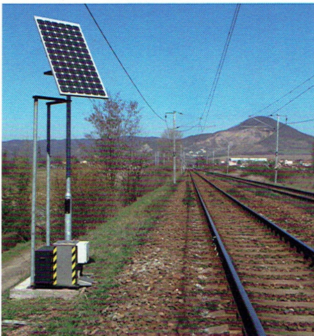
Kolejnicový mazník CL-E1 se solárním napájením – instalace v České republice na trati SŽDC
