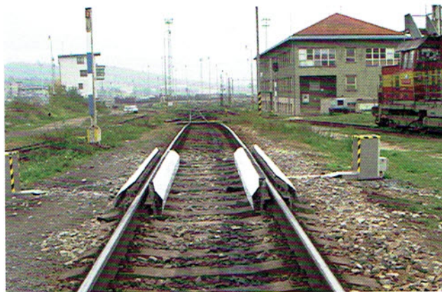
Protihlukový systém BREMEX-ANNSYS v ověřovacím provozu na železničním spádovišti SŽDC
